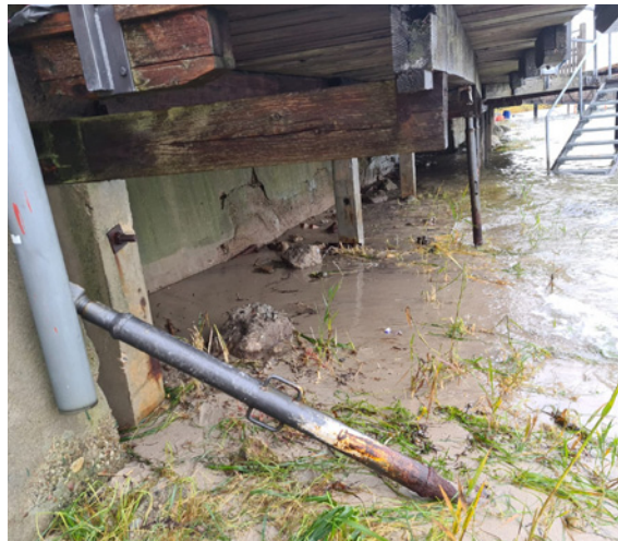
Pfahl unter der „Terrasse“ vor dem Haus weggebrochen
