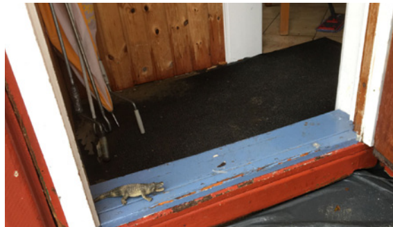
Wasser steht im Haus
