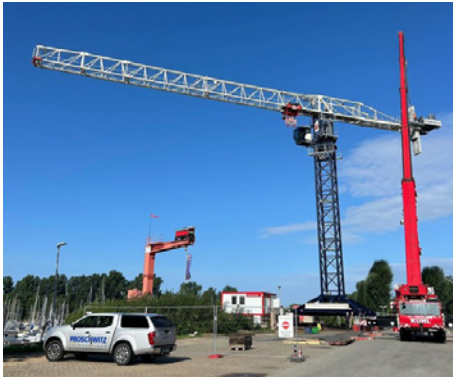
Gittermast als temporäre Lösung
